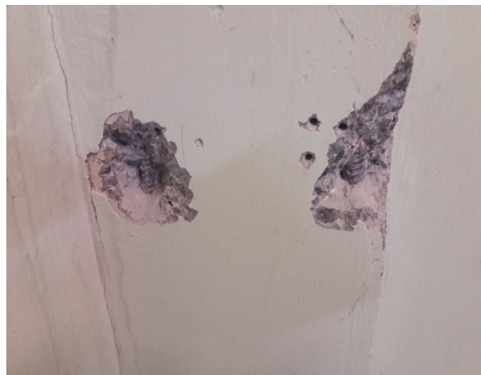
Фото 13. Вскрытие арматуры колонны 6 этажа.
