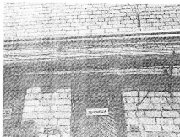
04.09.2020 г. Литер б - сеть электроснабжения
